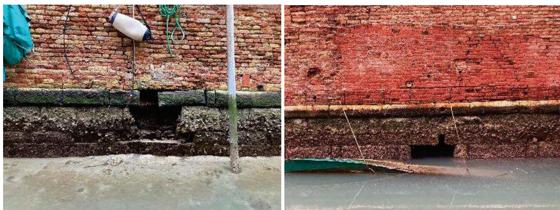
Crollo dei bolognini
