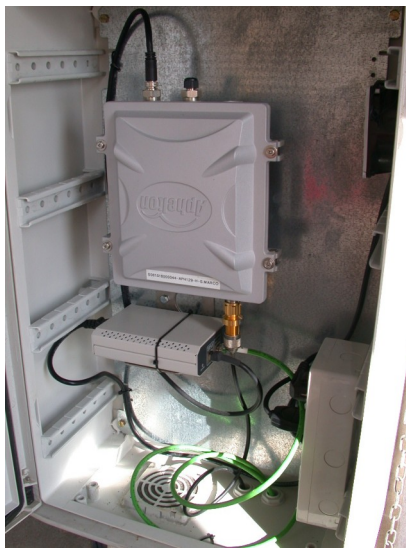
Foto 4 – Quadro Apparati Radio
