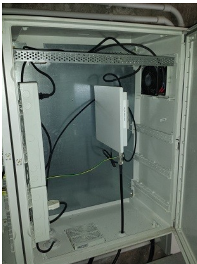
Foto 4 – Quadro Apparati Radio
