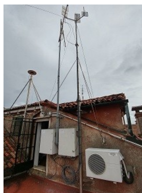
Foto 5 – Palo antenne Wi.Fi
