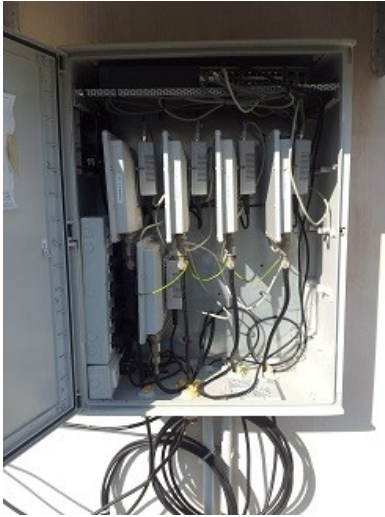
Foto 4 – Quadro Apparat Radio
