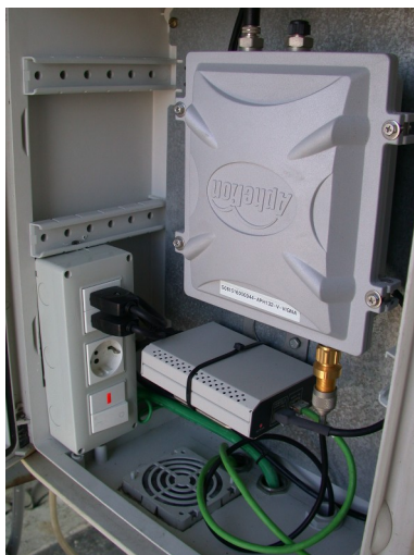
Foto 4 – Quadro Apparati Radio
