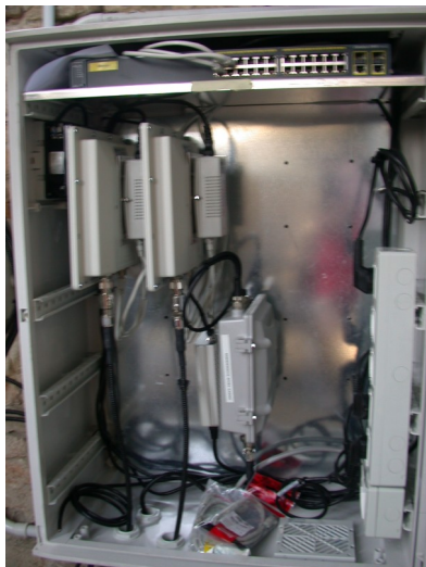
Foto 4 – Quadro Apparati Radio
