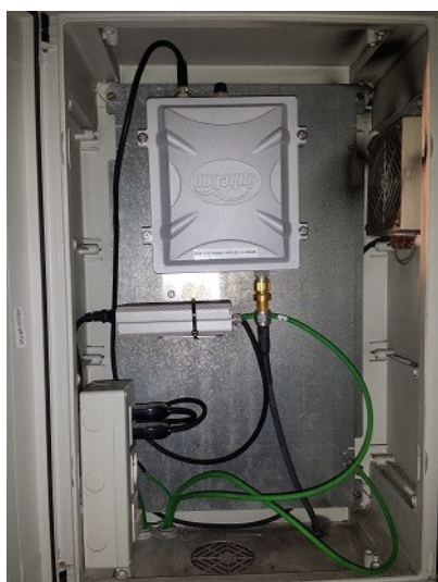
Foto 3 – Quadro Apparati Radio
