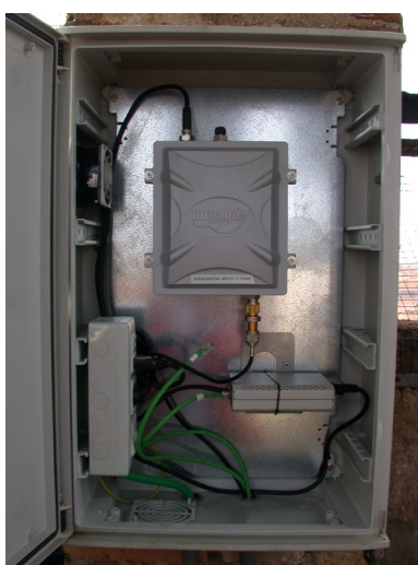
Foto 4 – Quadro Apparati Radio
