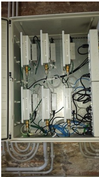
Foto 4 – Quadro Apparati Radio
