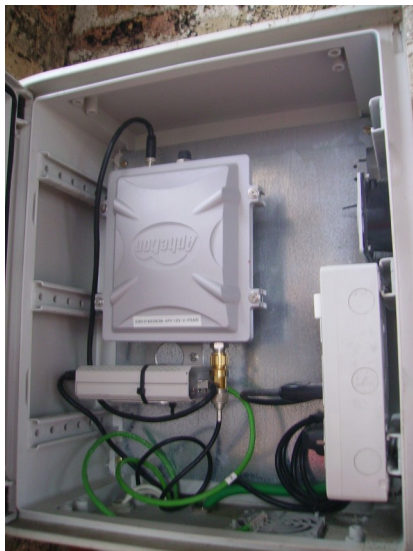
Quadro Apparati Radio
