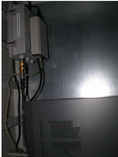
Foto 4 – Quadro Apparati Radio e UPS
