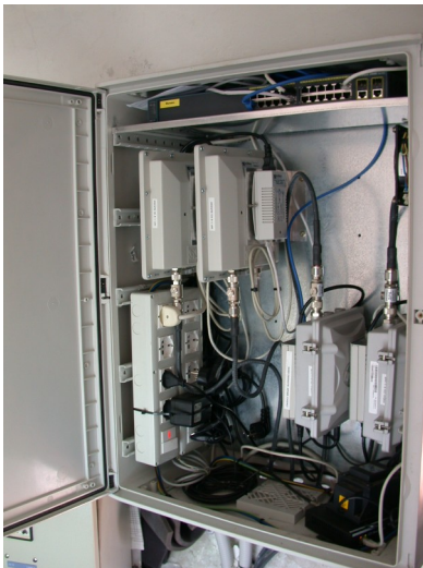
Foto 4 – Quadro Apparati Radio
