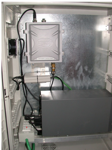
Foto 4 – Quadro Apparati Radio e UPS
