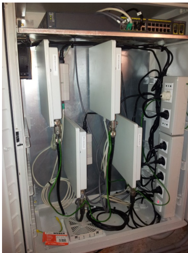
Foto 4 – Quadro Apparati Radio
