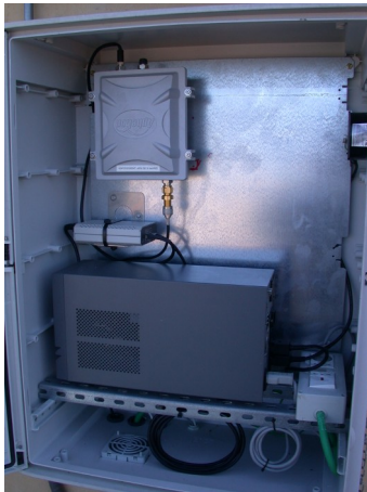
Foto 4 – Quadro Apparati Radio e UPS
