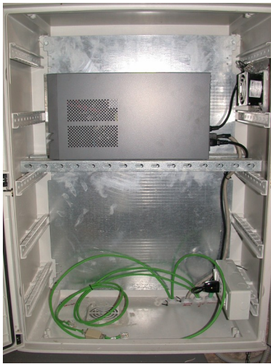
Foto 6 – Apparati UPS - Router
