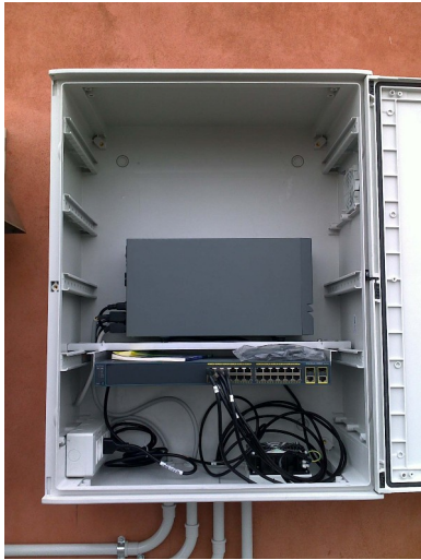
Foto 6 – Apparati UPS - Router
