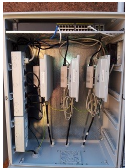
Foto 3 – Quadro Apparati Radio
