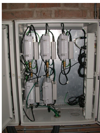
Foto 4 – Quadro Apparati Radio
