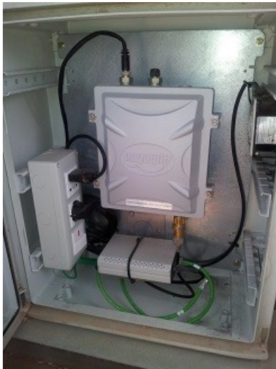
Foto 4 – Quadro Apparati Radio
