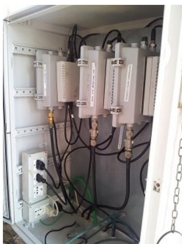
Foto 4 – Quadro Apparati Radio
