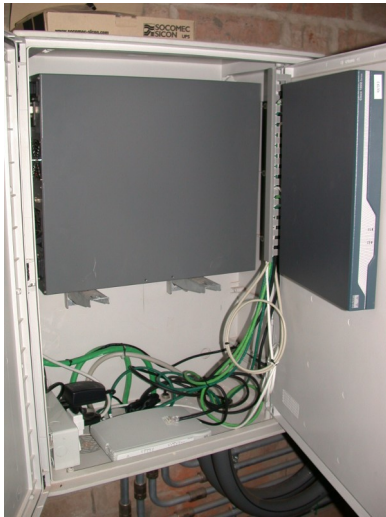
Foto 6 – Apparati UPS - Router
