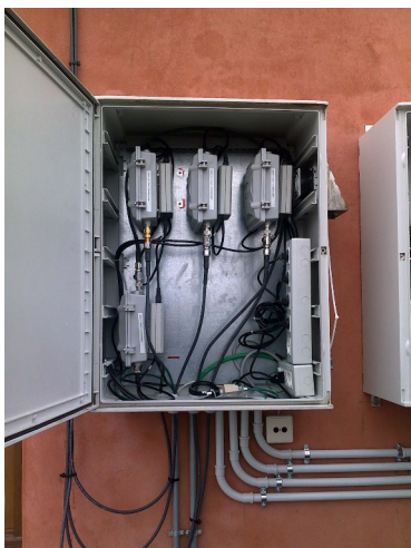
Foto 4 – Quadro Apparati Radio
