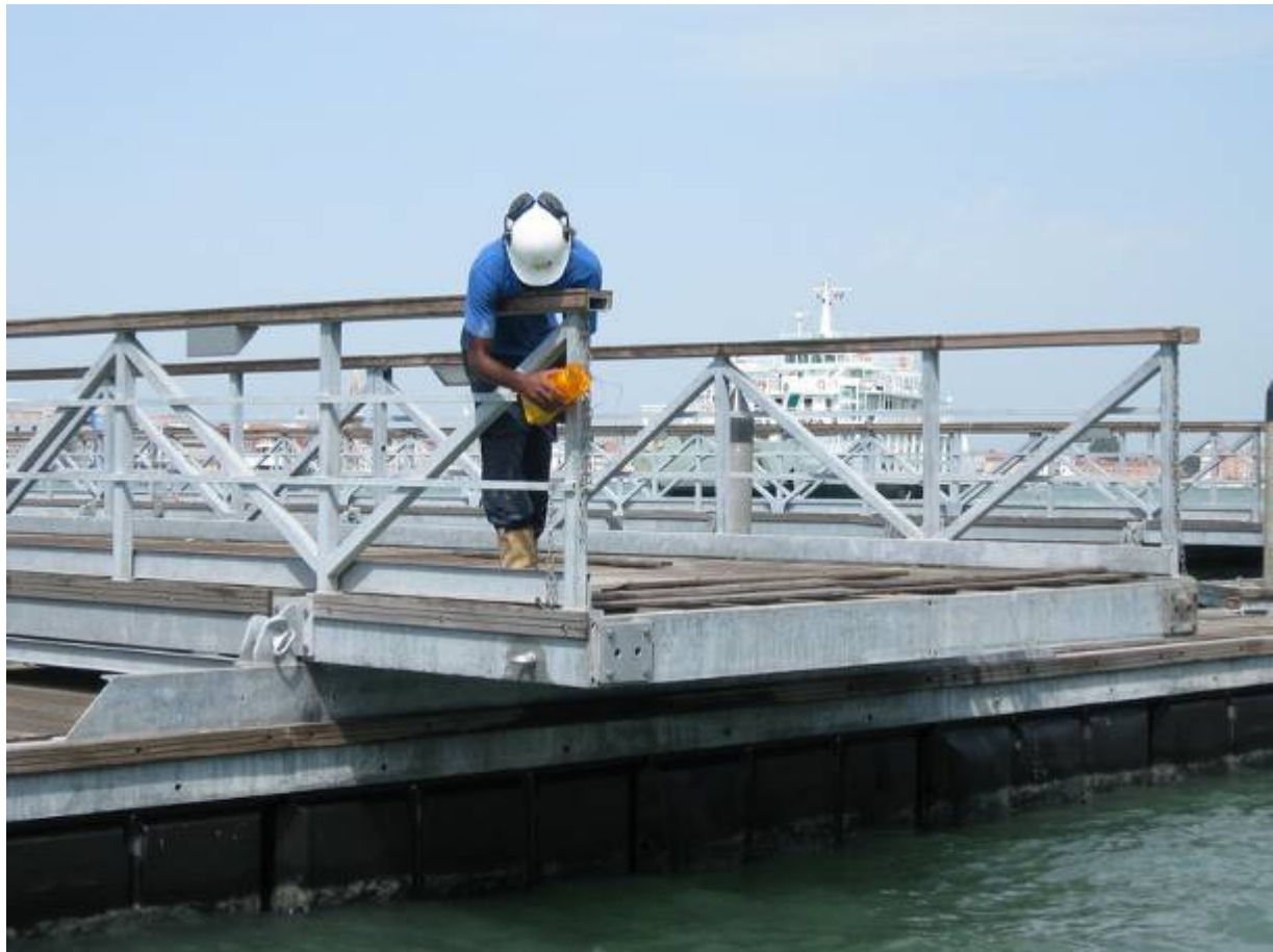
Collegamento luci di segnalazione
