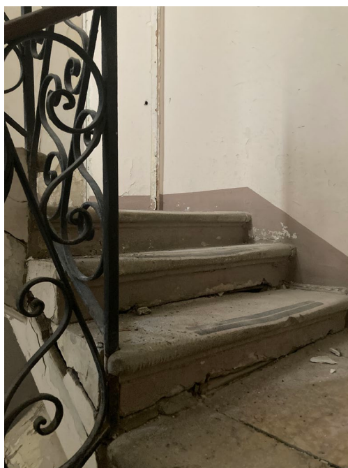
Foto dei dissesti dei gradini
