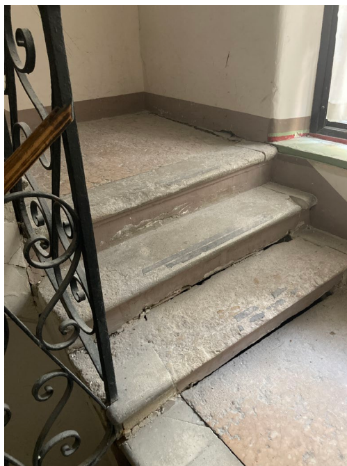
Foto dei dissesti dei gradini
