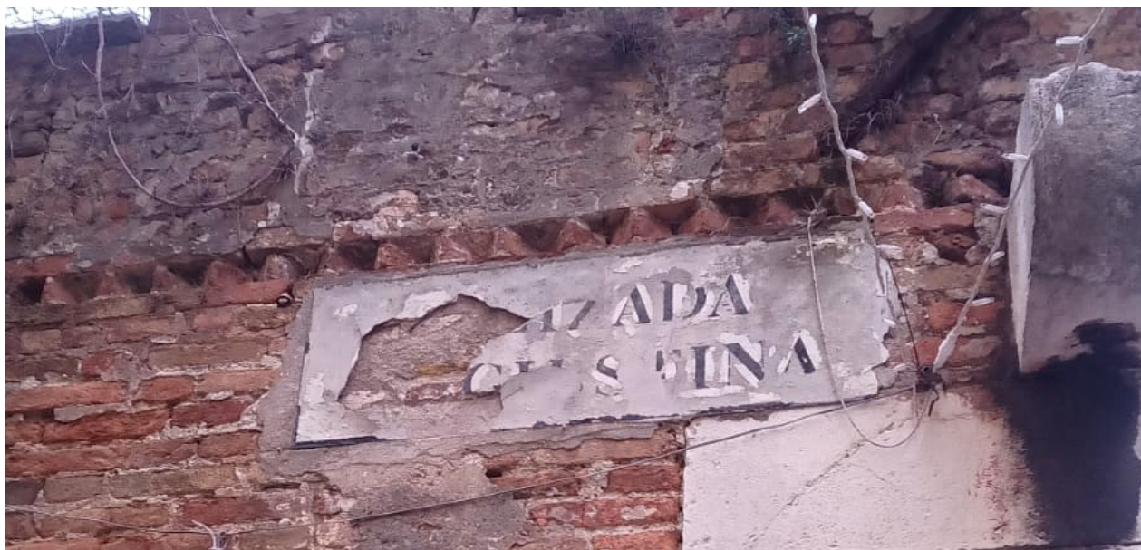
Esempio di deterioramento di un nizioleto
