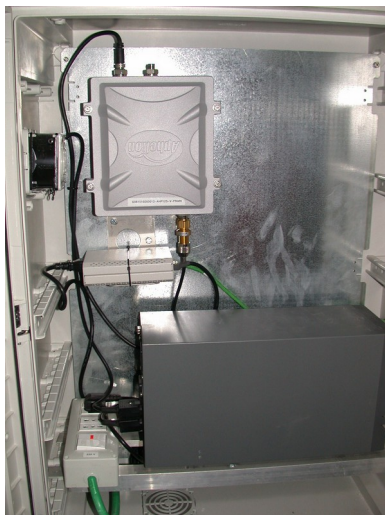
Foto 4 – Quadro Apparati Radio e UPS
