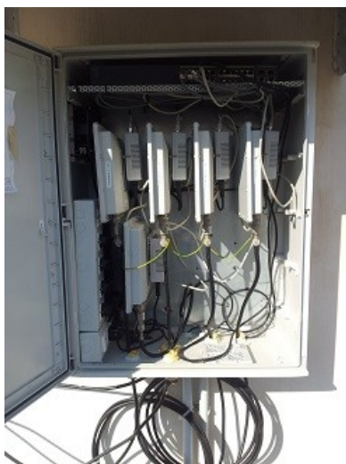
Foto 4 – Quadro Apparat Radio
