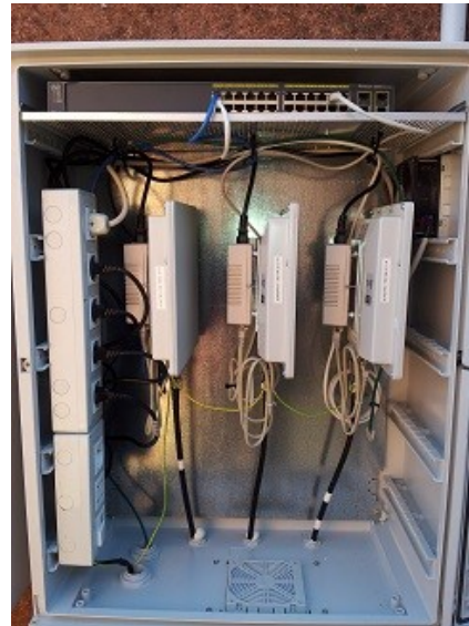
Foto 3 – Quadro Apparati Radio
