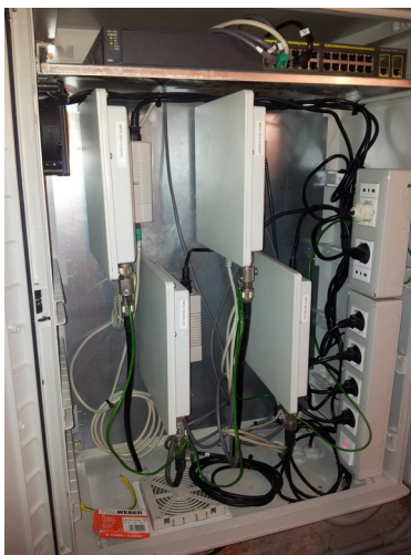
Foto 4 – Quadro Apparati Radio
