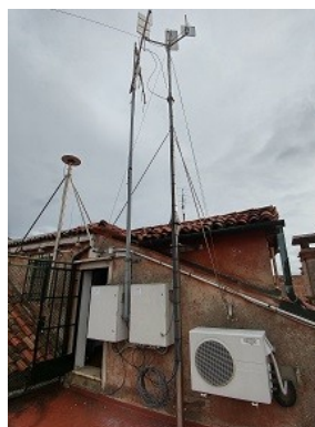
Foto 5 – Palo antenne Wi.Fi
