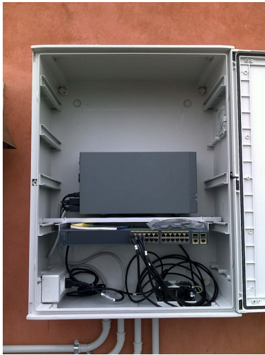
Foto 6 – Apparati UPS - Router
