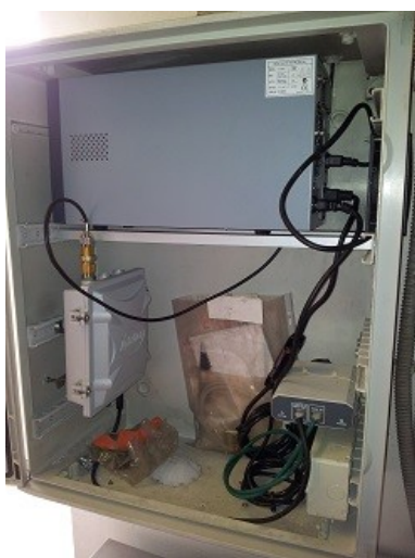
Foto 4 – Quadro Apparati Radio e UPS
