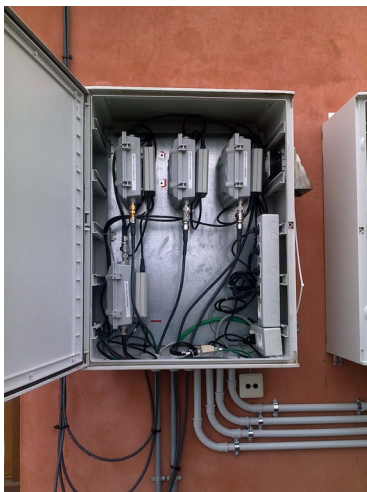
Foto 4 – Quadro Apparati Radio
