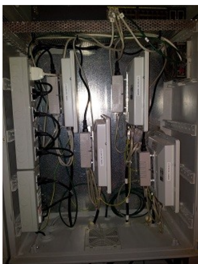
Foto 4 – Quadro Apparati Radio
