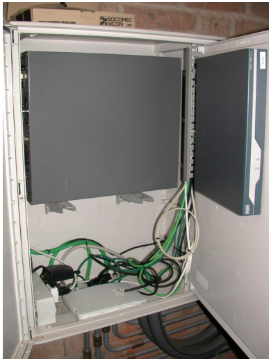
Foto 6 – Apparati UPS - Router
