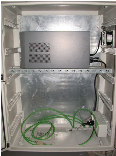
Foto 6 – Apparati UPS - Router
