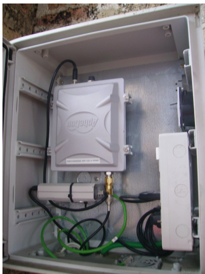
Quadro Apparati Radio
