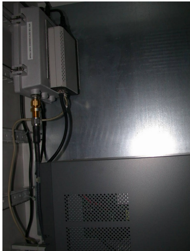
Foto 4 – Quadro Apparati Radio e UPS
