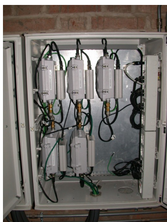
Foto 4 – Quadro Apparati Radio
