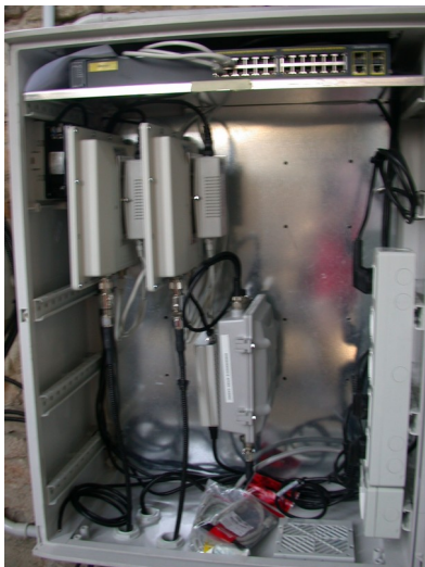
Foto 4 – Quadro Apparati Radio
