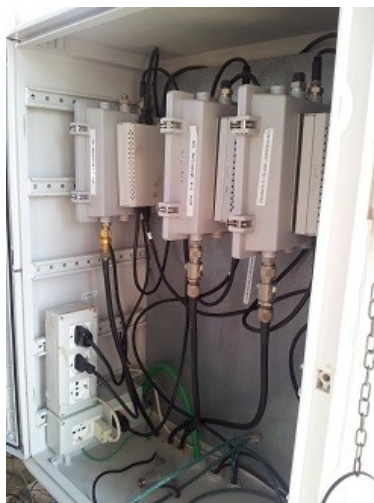
Foto 4 – Quadro Apparati Radio
