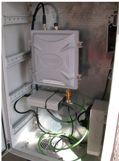
Foto 4 – Quadro Apparati Radio
