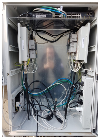
Foto 3 – Apparati Radio interno Quadri
