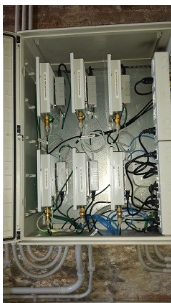
Foto 4 – Quadro Apparati Radio
