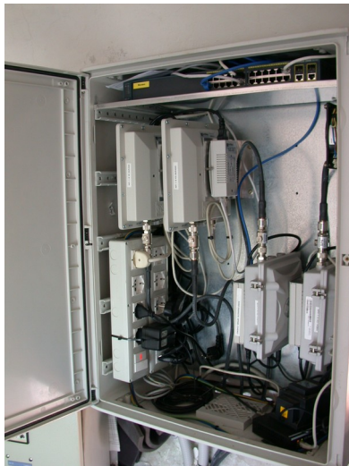
Foto 4 – Quadro Apparati Radio
