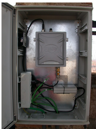
Foto 4 – Quadro Apparati Radio
