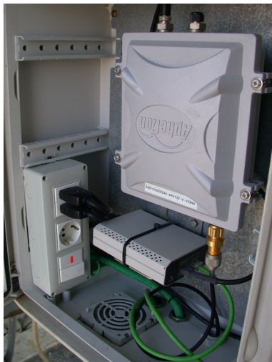
Foto 4 – Quadro Apparati Radio
