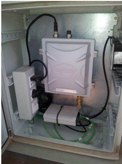
Foto 4 – Quadro Apparati Radio
