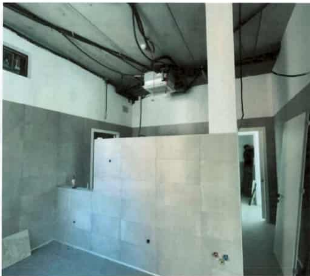
Foto n.5 – fasi di realizzazione delle lavorazioni per gli impianti meccanici e di climatizzazione dei bagni
