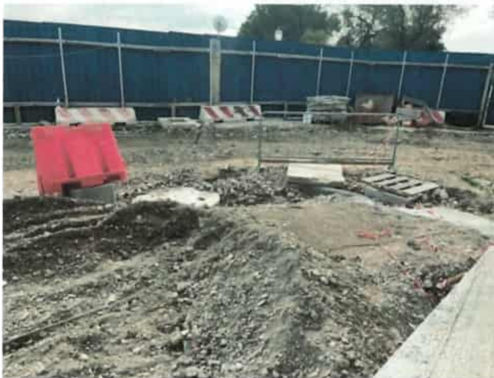
Foto n.8 e 9 – fasi di scavo e realizzazione delle reti esterne dei sottoservizi, compresi i pozzetti
