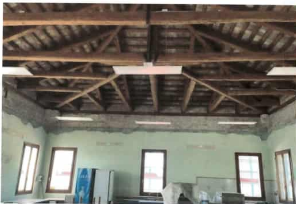
Foto n.3 – Cordolo perimetrale in muratura realizzato a sostegno della struttura di copertura del fabbricato esistente
