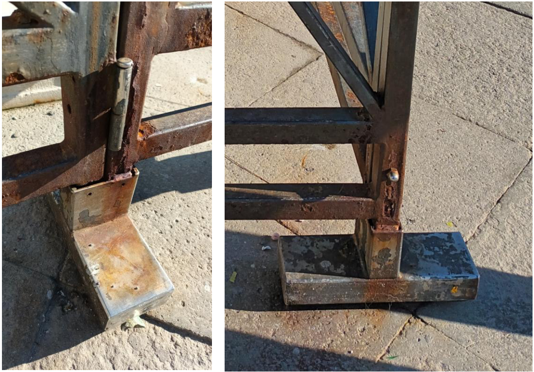
Figura 4–7 Ossidazione e corrosione diffusa delle basi dei recinti dei pili portabandiera
