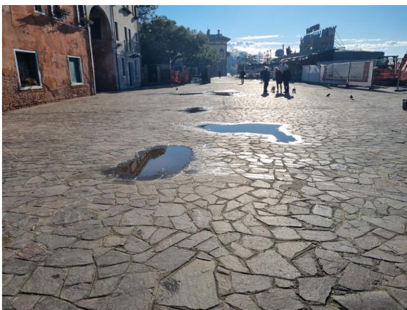
La pavimentazione in piastrelle di porfido, le pozzanghere evidenziano i principali avvallamenti presenti
