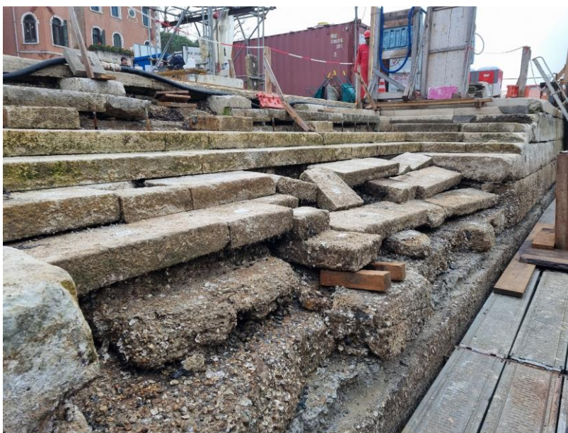
Riva d'acqua ovest prima dei lavori: qui i gradoni rientrano rispetto al filo dei cassoni e molti dei blocchi lapidei sono andati perduti
