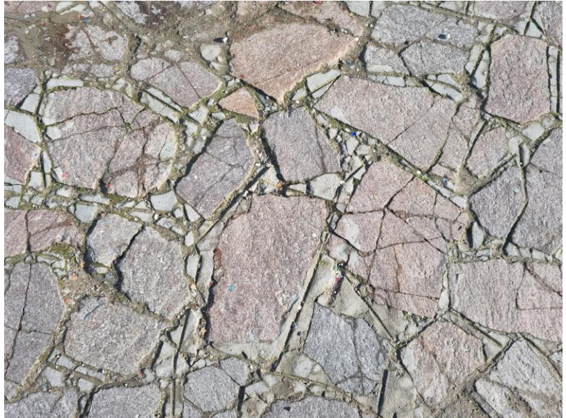
Il degrado della pavimentazione in piastrelle di porfido
