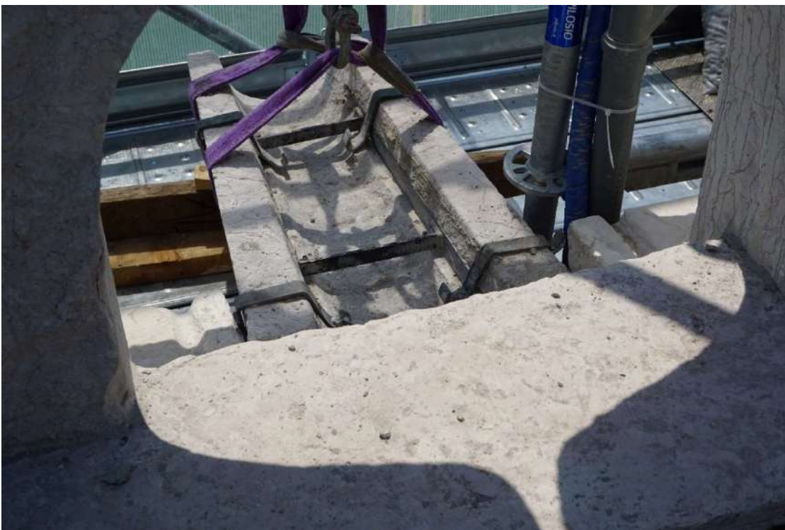
Doccione D-01 – Dopo l'intervento di rimozione delle malte che ostruivano il doccione.
