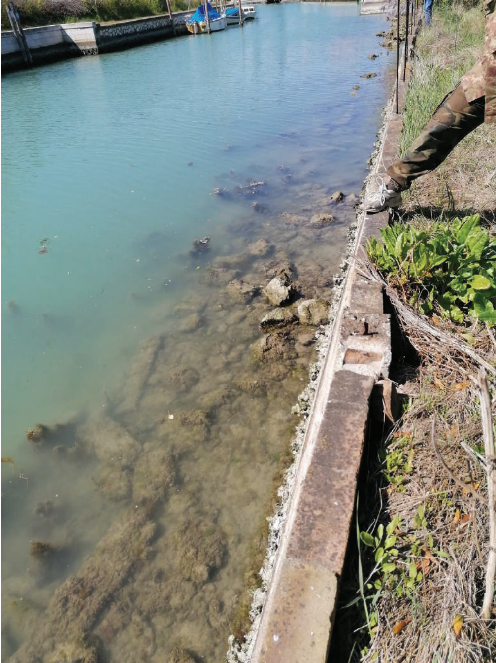
Figura 9 – Vista del muretto su marginamento dissestato
