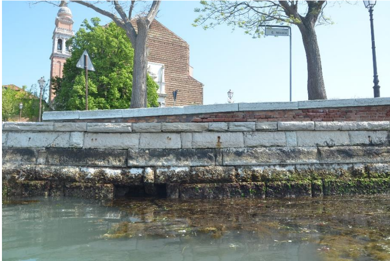
Figura 1.4: Dissesto del paramento con mancanza del bolognino
