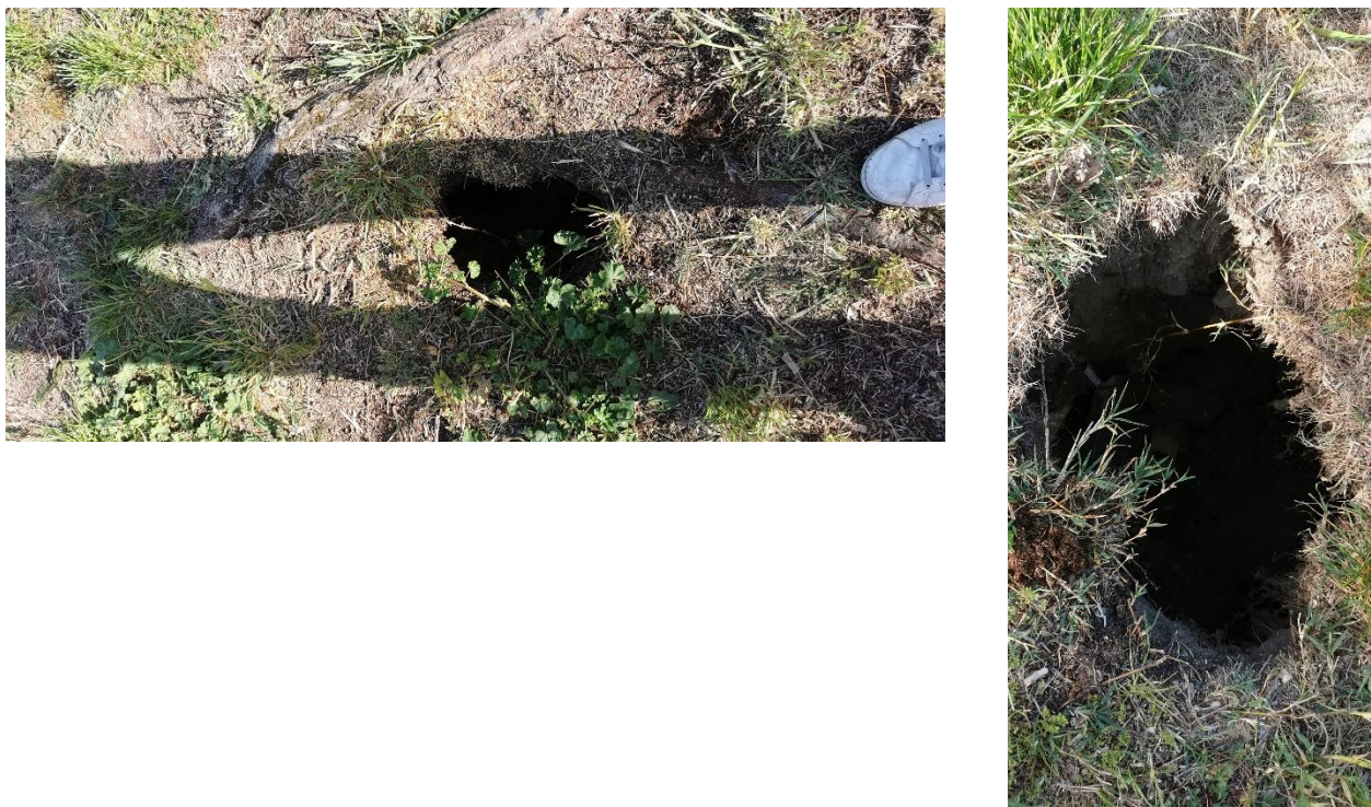
Figura 0.3: Cedimenti con svuotamento del terreno in corrispondenza alla riva più alta in calcestruzzo
