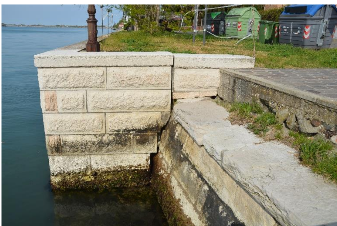
Figura 1.2: Lesione tra intersezione delle due rive
