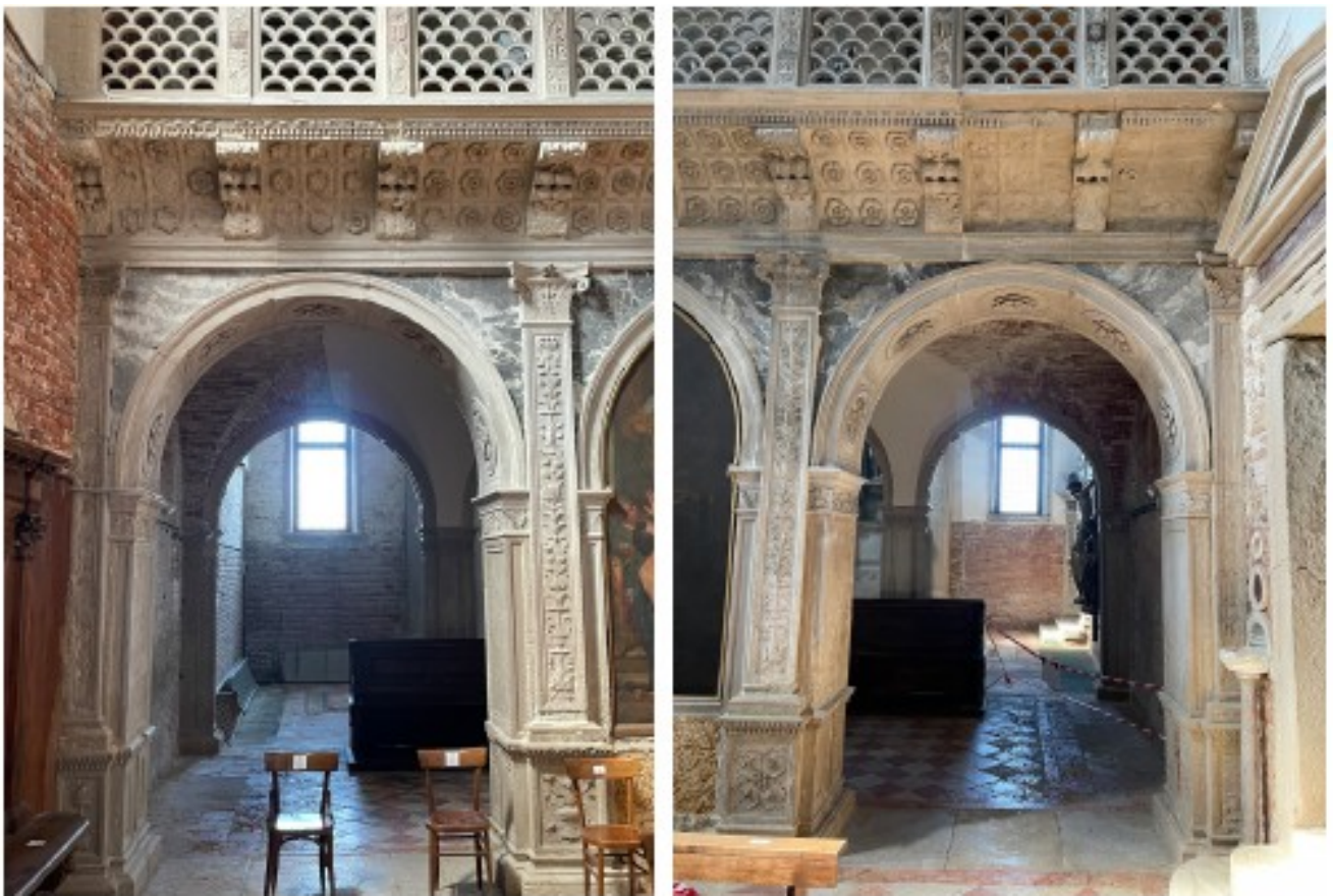
Chiesa di San Michele in Isola. Prospetto lato est del Barco con tratti ammalorati della Cantoria
