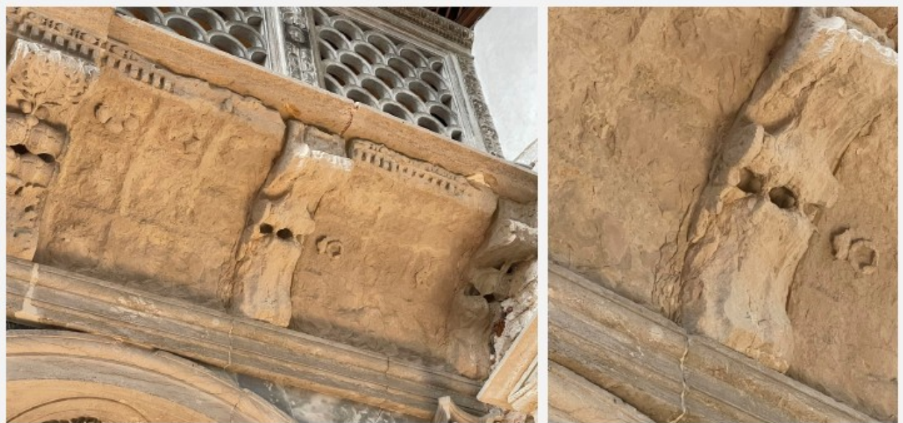
Cantoria. Dettaglio ammaloramenti
