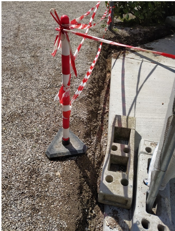
Dettaglio del dislivello fra rampa e terreno limitrofo – Stato di fatto.
