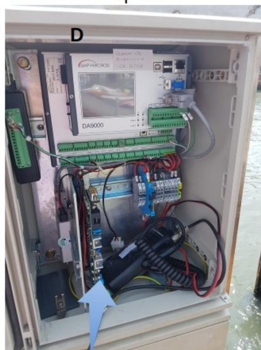
Circuito a bassa tensione
