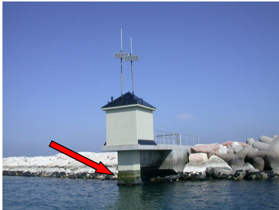
Foto 3 Pozzetto di Calma Diga Sud Lido
