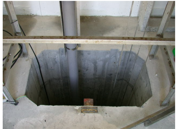
Foto 4 Pozzetto di Calma Diga Sud Lido
