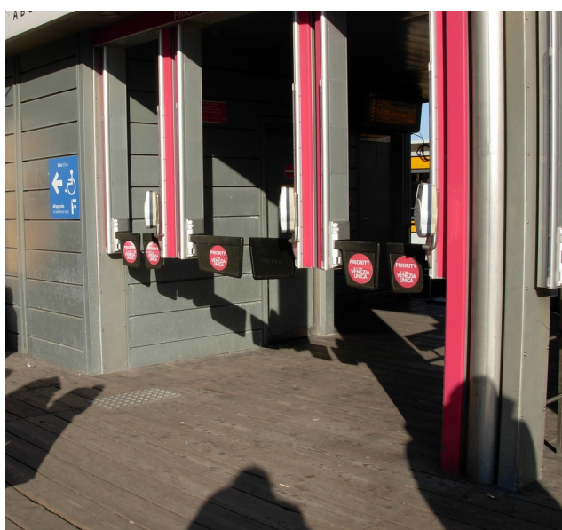
Pontile con tornelli mancante della discesa a terra degli elementi verticali
