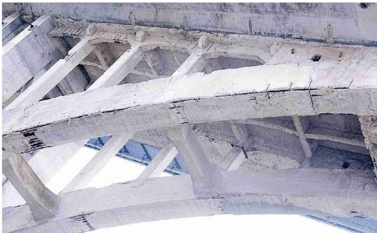
Cemento dei ponti che si sbriciola: sono migliaia le opere usurate che hanno bisogno di manutenzione
