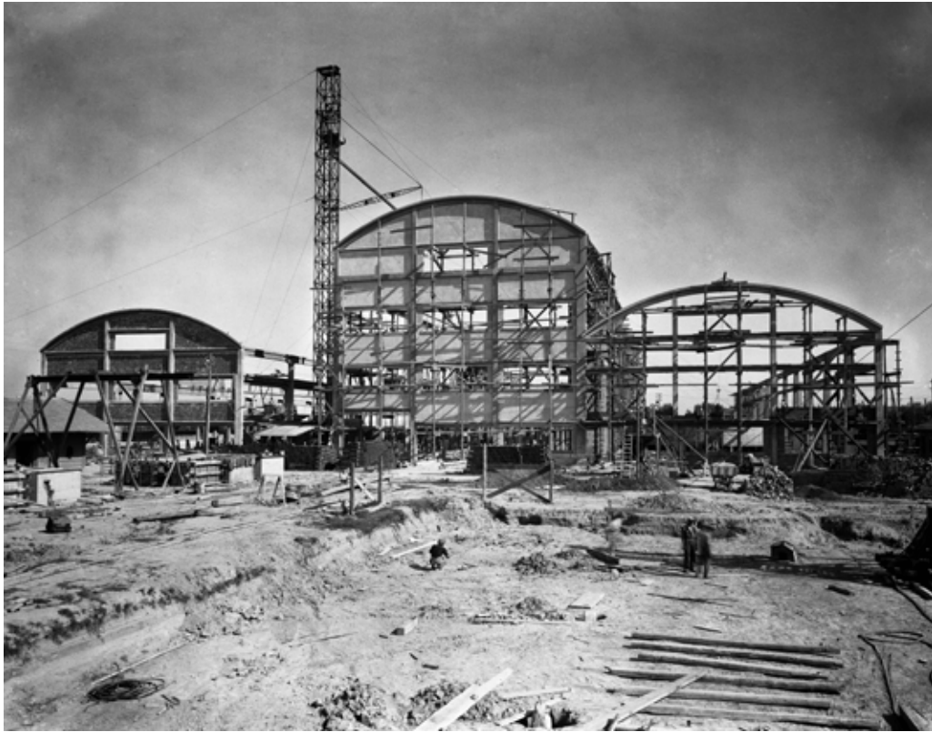
Venezia, Marghera, SACAİM cantiere costruzione dell'impianto Montecatini per la lavorazione dello zinco a Marghera - 1935
