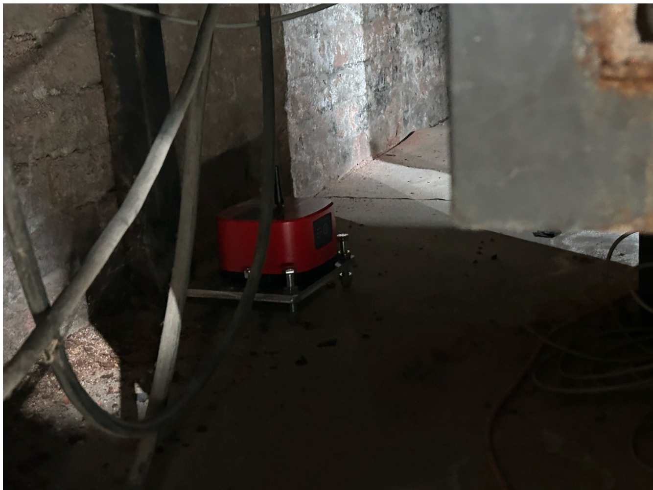
Installazione dispositivo di rilevamento vibrazioni all'interno di Biennale
