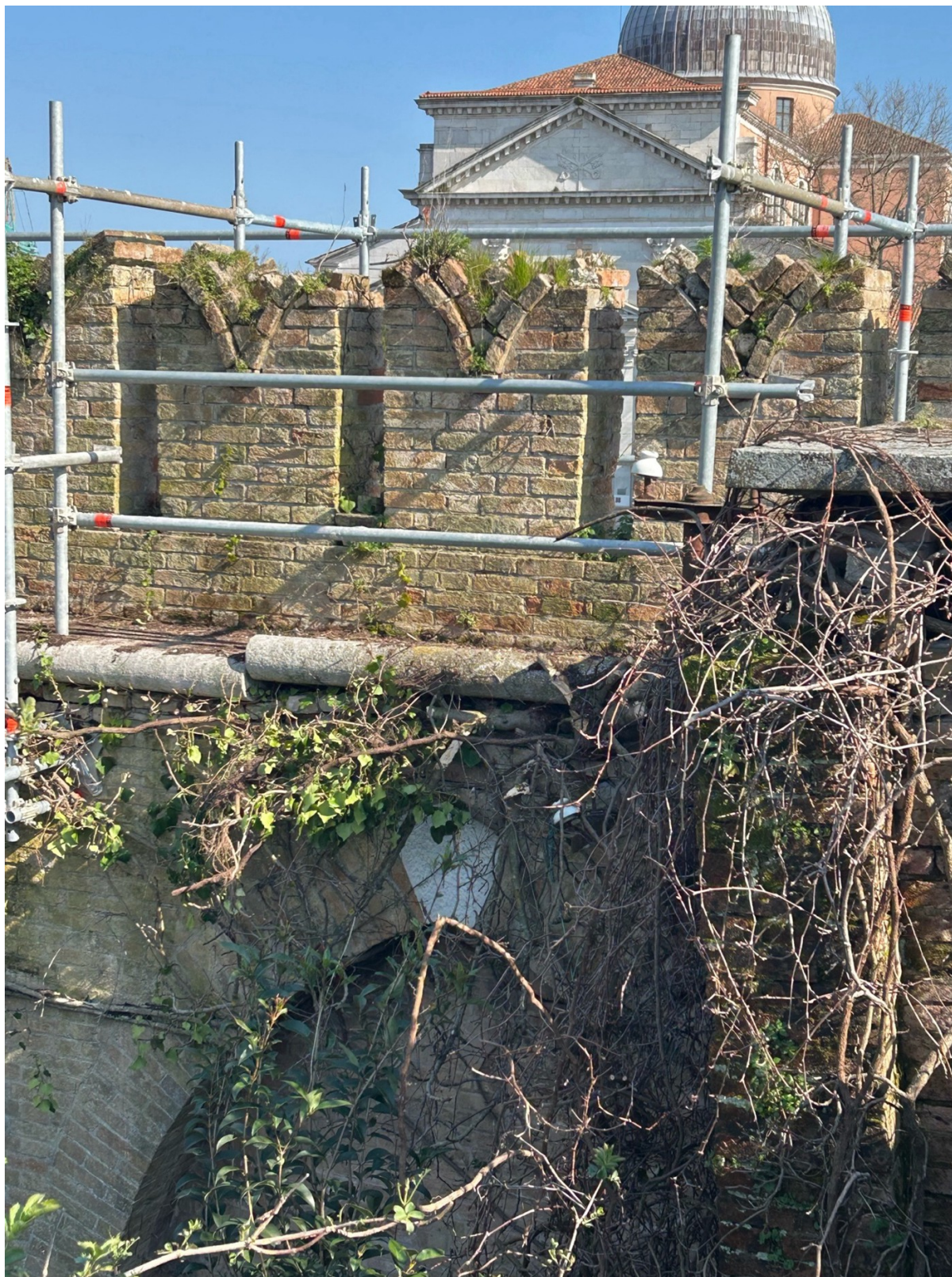
Dissesti causati dalla vegetazione del camminamento in pietra dei giardini delle Vergini di Biennale
