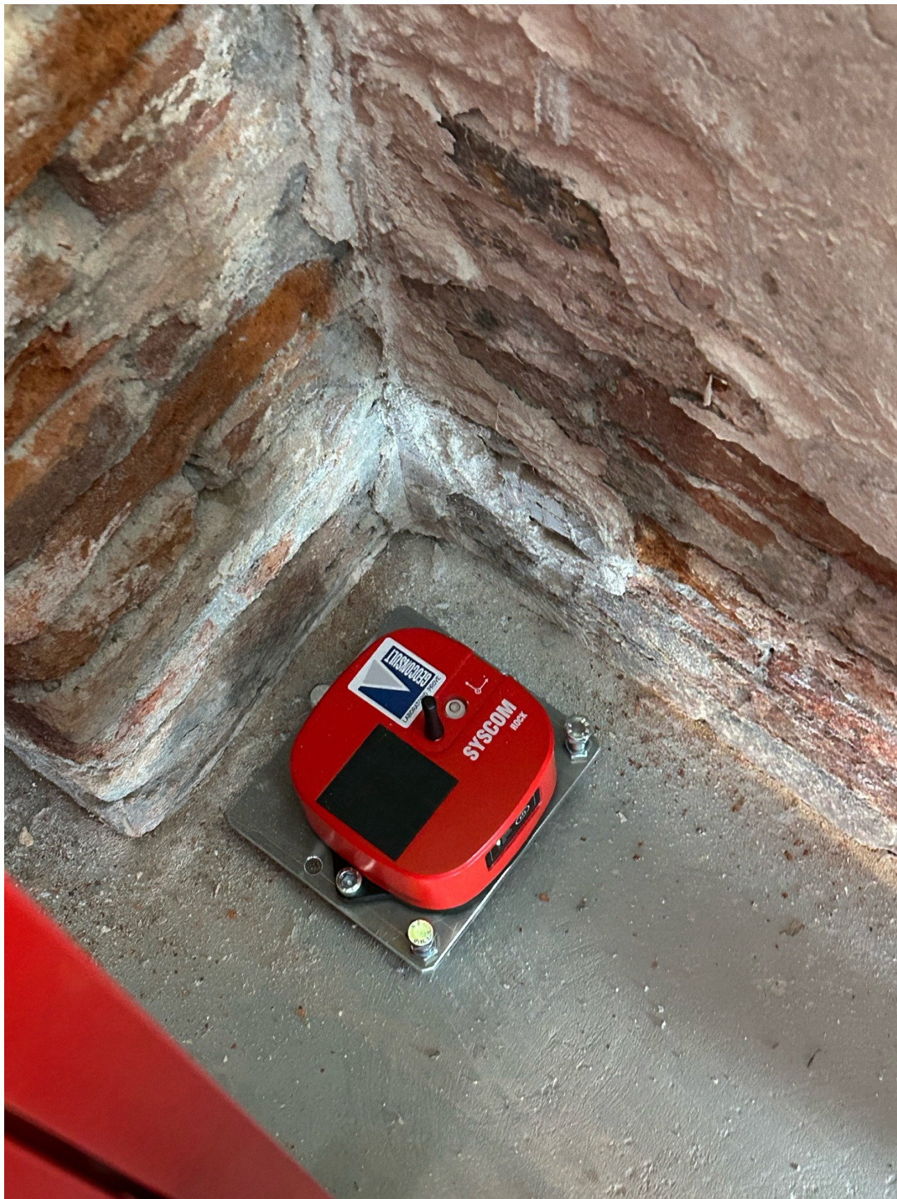
Installazione dispositivo di rilevamento vibrazioni all'interno di Biennale
