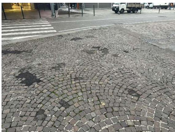
Pavimentazione da ripristinare
