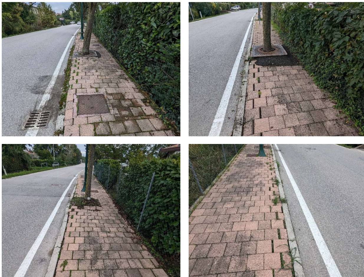
via Litomarino - pavimentazione in betonelle sconnessa
