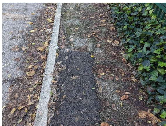
Marciapiede lato sud – tratto con radici
