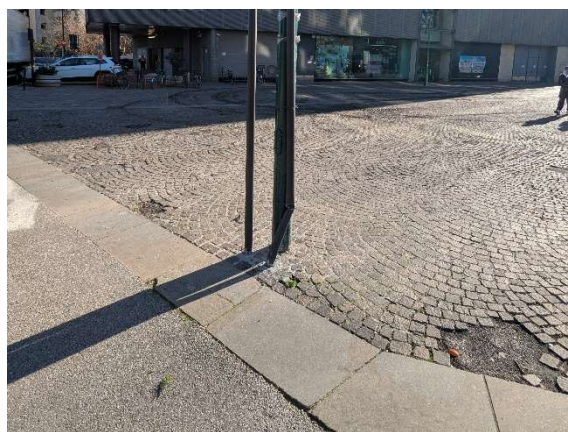
Pavimentazione da ripristinare
