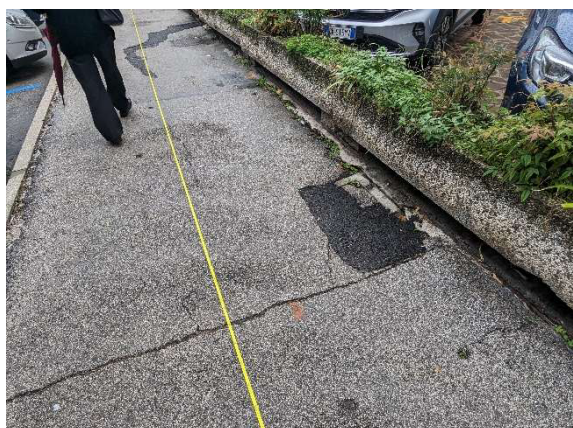
Marciapiede lato sud – cedimento
