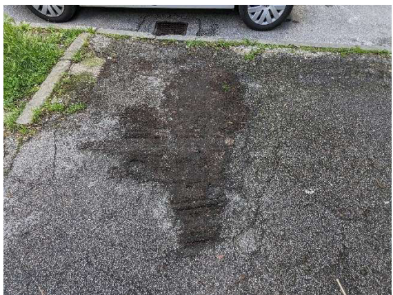
Pavimentazione marciapiede – cedimento
