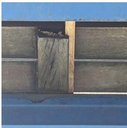
Marcescenza morale in corrispondenza del giunto lato est
