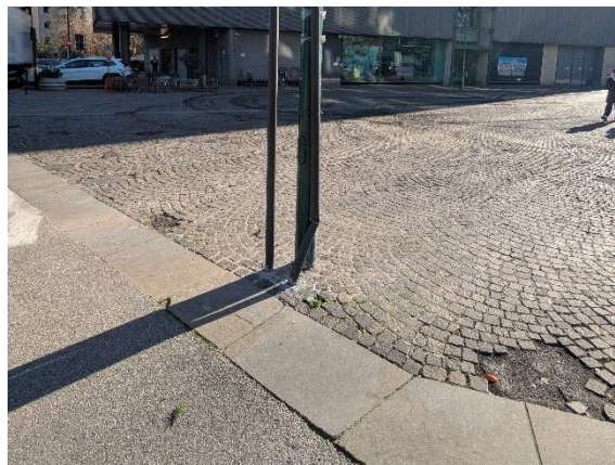
Pavimentazione da ripristinare
