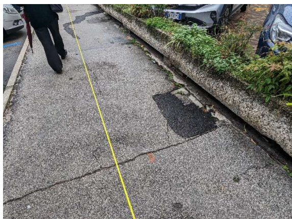
Marciapiede lato sud – cedimento
