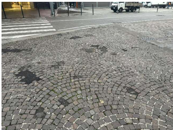
Pavimentazione da ripristinare
