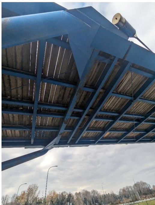
Degrado traverso puntoni lato est
