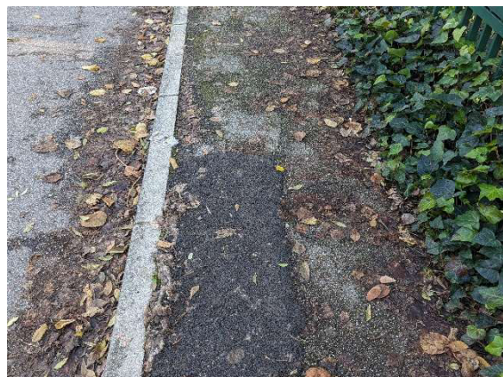
Marciapiede lato sud – tratto con radici
