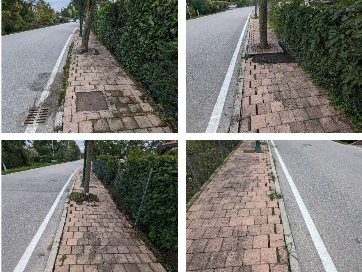
via Litomarino - pavimentazione in betonelle sconnessa
