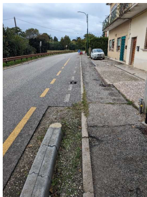
Linea gialla e cordone da rimuovere
