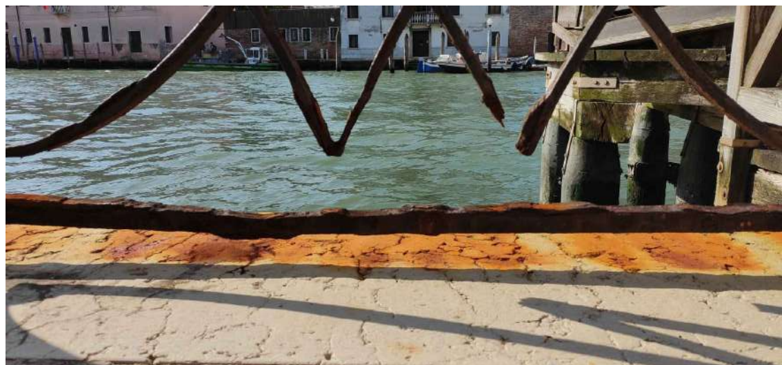
Parapetto intaccato dalla ruggine con tratti di fregio rotti
