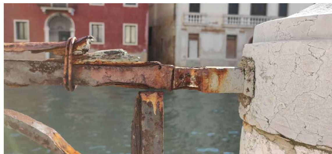
Montante, traversa e corrimano staccati
