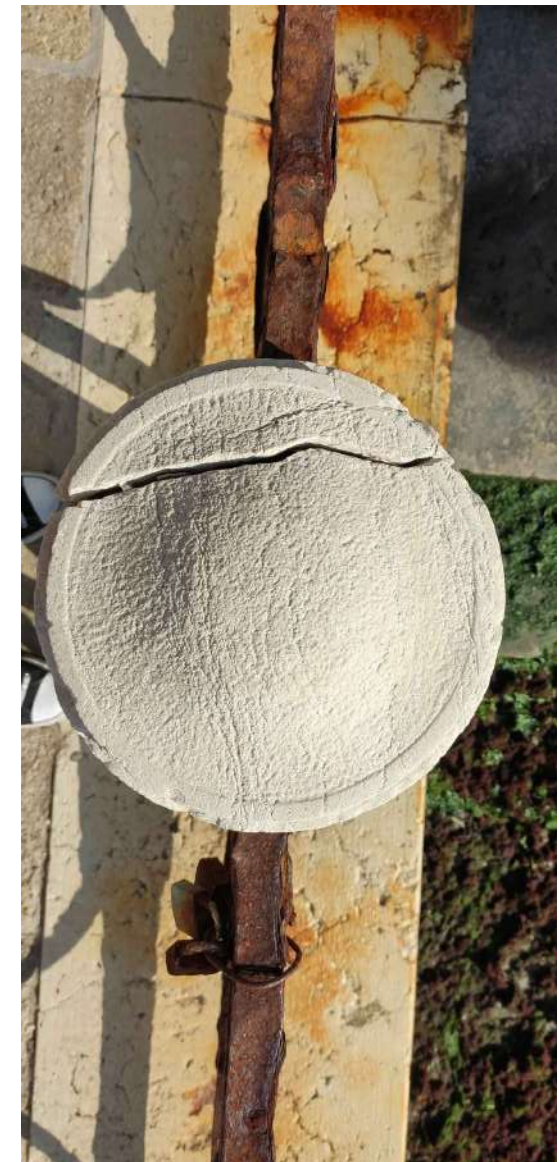
Cappello della colonna fessurato
