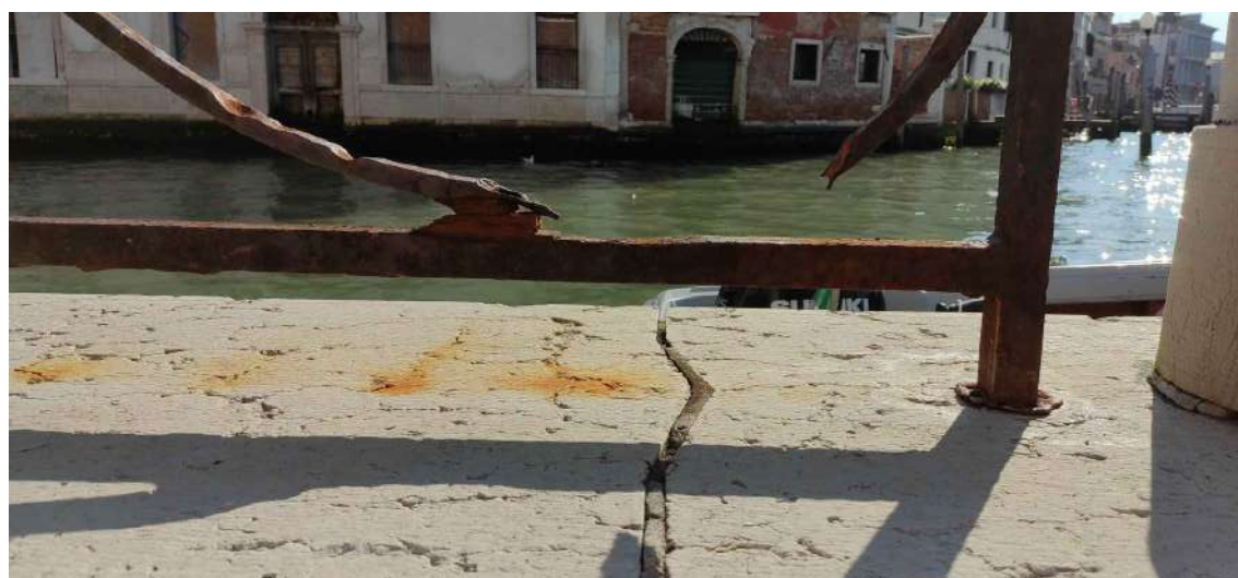
Parapetto intaccato dalla ruggine con tratti di fregio mancanti
