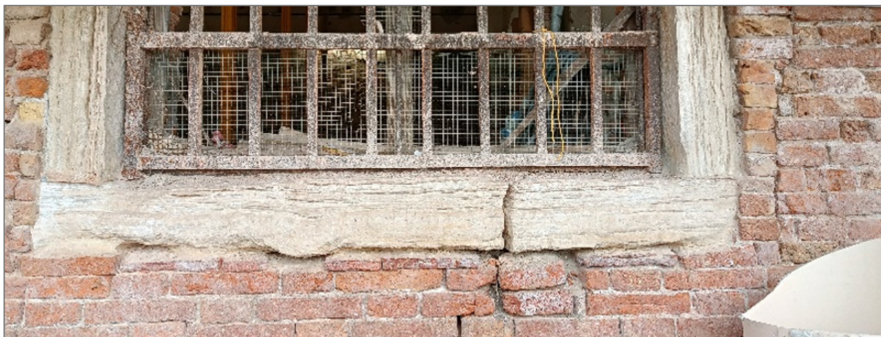
Fig. 28. Immagini di dettaglio: stato di degrado della cornice in pietra
