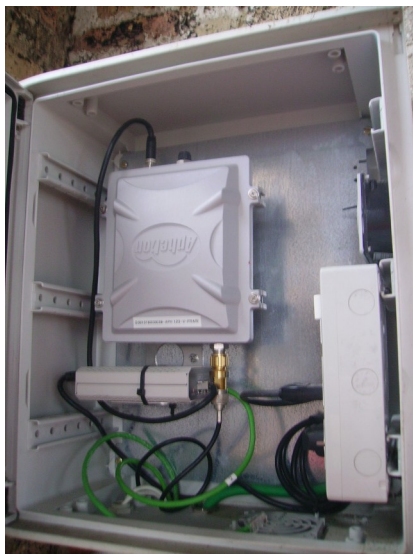
Quadro Apparati Radio
