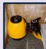
FILTRO A SABBIA VANO TECNICO
