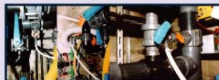
VALVOLE PER DOSAGGIO CLORO
