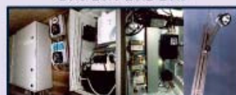
QUADRO AUTOMATISMI, SENSORI DI ALLARME, TELECAMERE VIDEOSORVEGLIANZA
