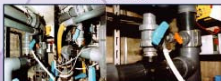
VALVOLE SISTEMA DI FILTRAGGIO
