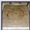
POZZETTO IN GHISA ACCESSO VANO TECNICO
