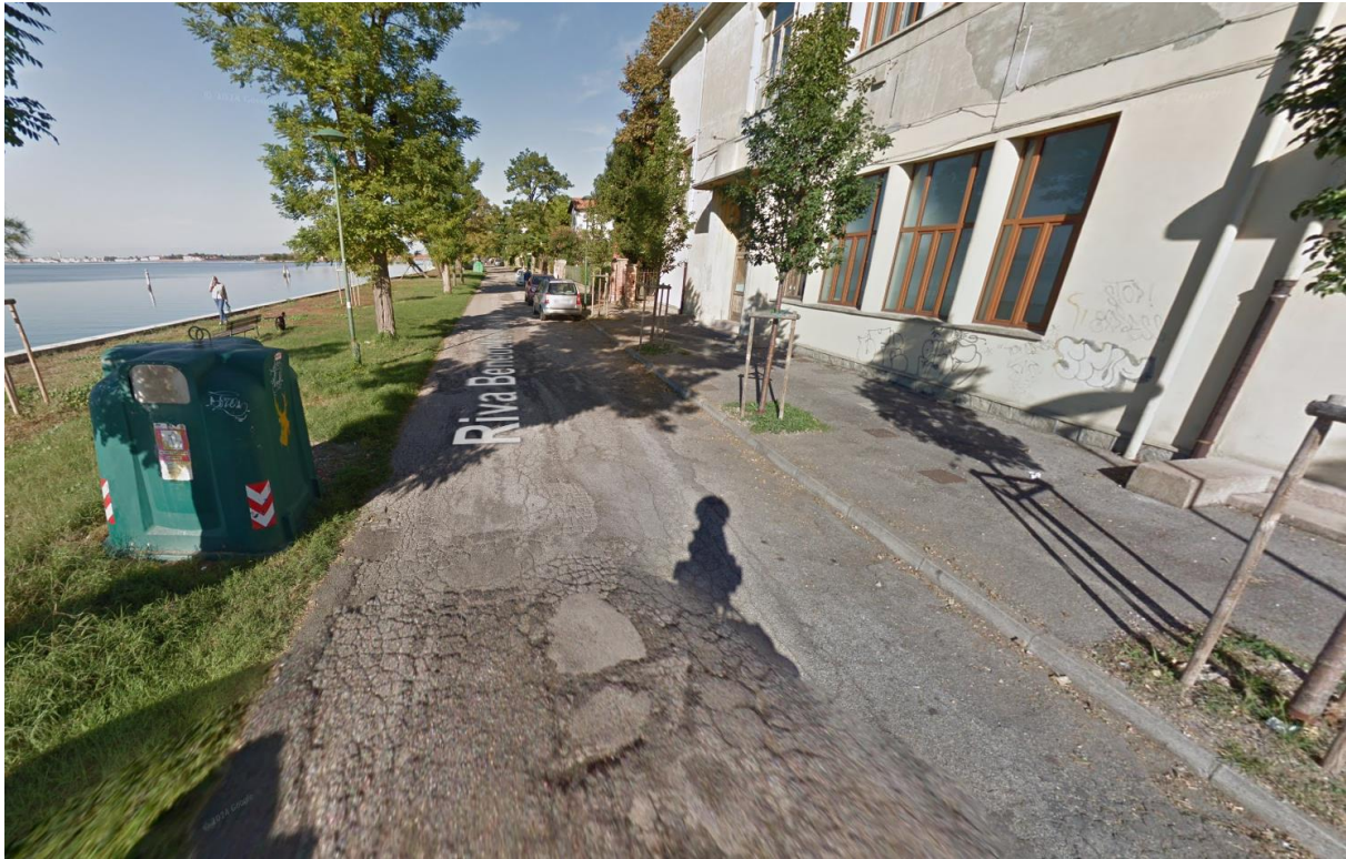
Figura 3: Riviera Benedetto Marcello degrado sede stradale
