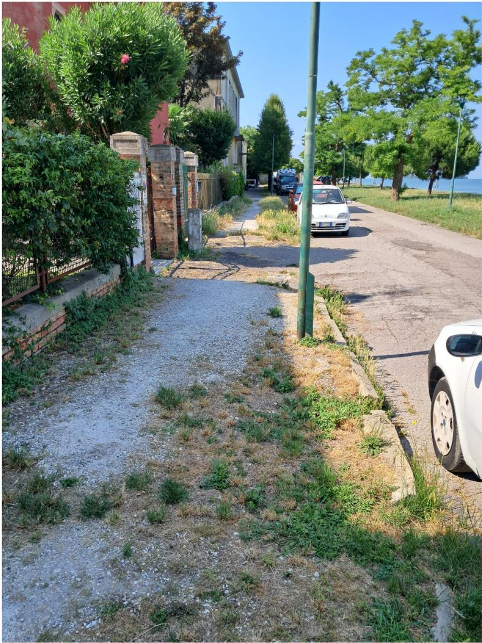
Figura 2: Riviera Benedetto Marcello degrado marciapiede
