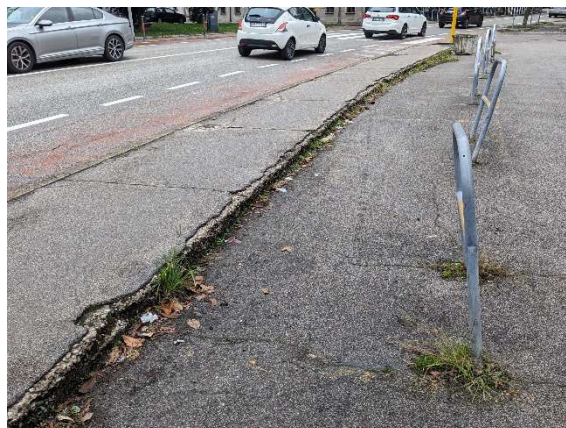
Pavimentazione marciapiede – tratto 1, senza cordone sul lato interno
