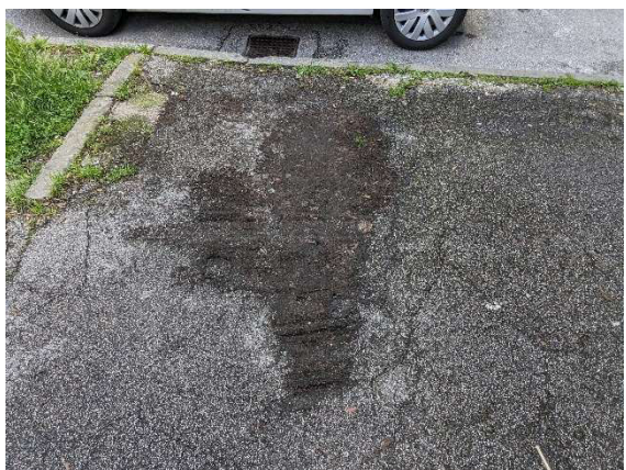
Pavimentazione marciapiede – cedimento
