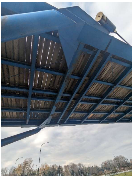
Degrado traverso puntoni lato est
