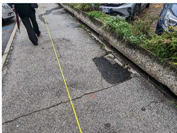
Marciapiede lato sud – cedimento
