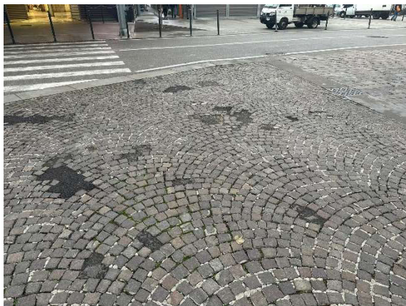
Pavimentazione da ripristinare
