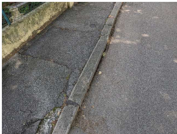
cordone disallineate su marciapiede lato ovest
