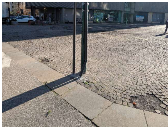
Pavimentazione da ripristinare
