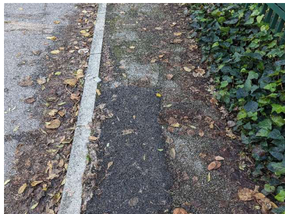
Marciapiede lato sud – tratto con radici
