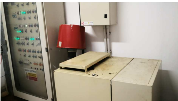
Soffianti e quadro comandi
