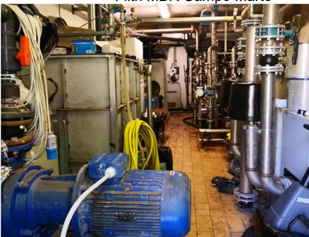
Interno locale tecnico Campo Marte
