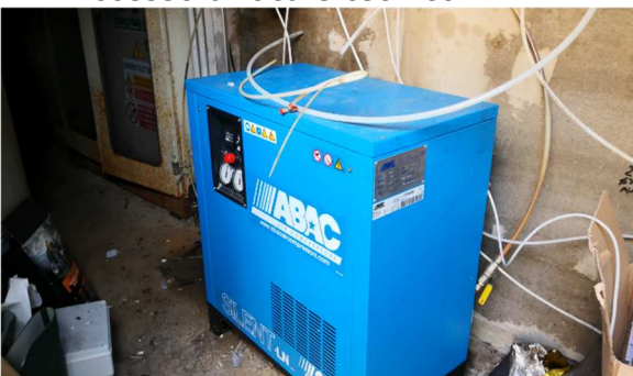
Interno locale tecnico – compressore e soffianti
