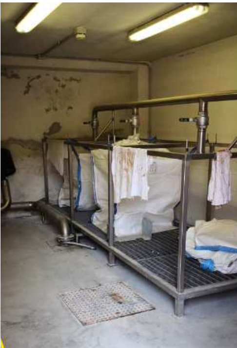
Locale tecnico (parte d'impianto sacconi fanghi essiccati non operativa)
