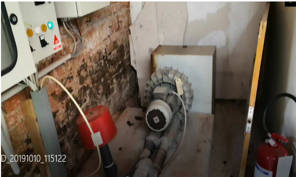
Soffiante Locale tecnico
