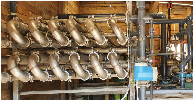
Membrane nel locale tecnico
