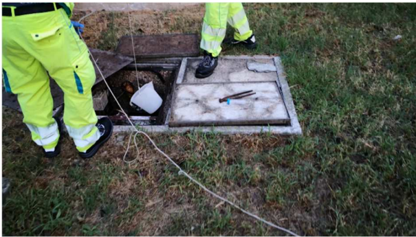
Vasca ossidazione depuratore
