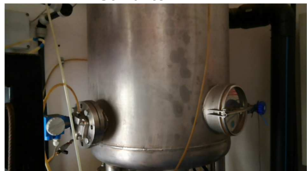
Serbatoio del vuoto
