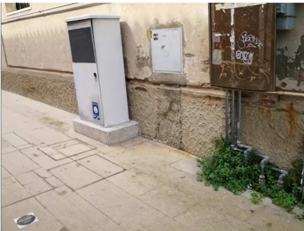
Quadro elettrico - contatore
