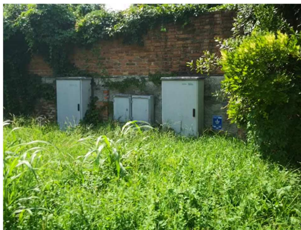
Quadro elettrico principale
