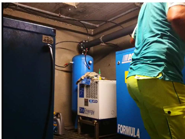
Impianto a pressione
