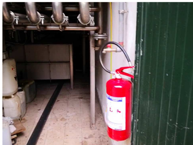
Locale tecnico filtri membrane
