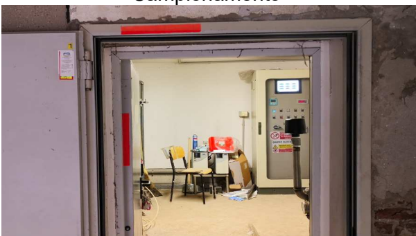
Porte tagliafuoco accesso locale tecnico
