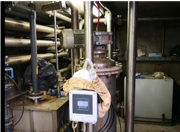
Locale tecnico: filtri a membrane
