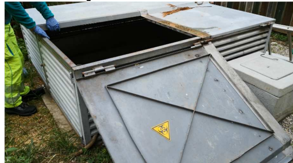
Accesso locale tecnico
