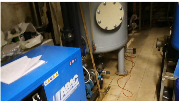
Interno locale filtri
