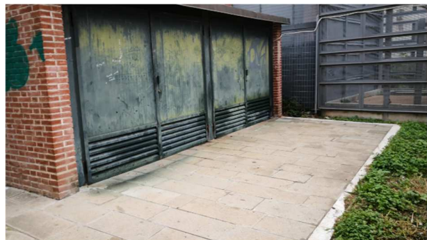
Vano ispessitore fanghi
