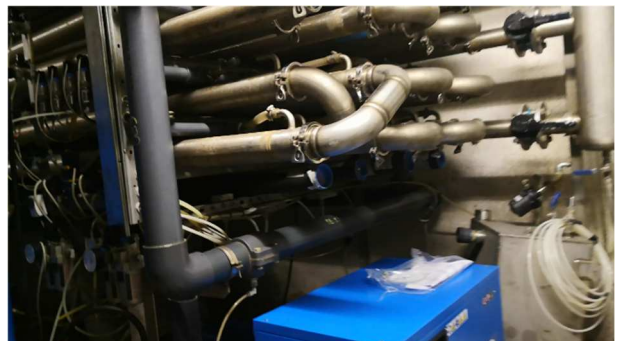
Interno locale filtri
