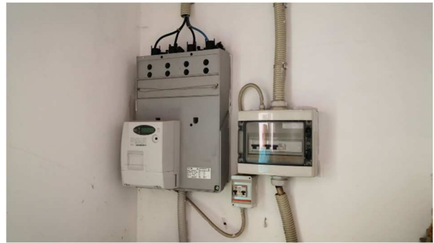
Quadro elettrico impianto
