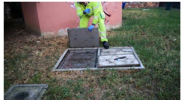
Vasca ossidazione depuratore
