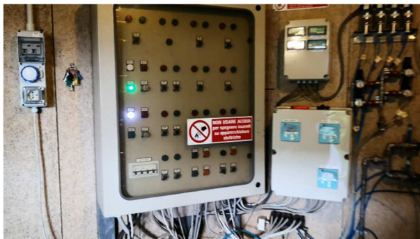
Quadro comandi depuratore
