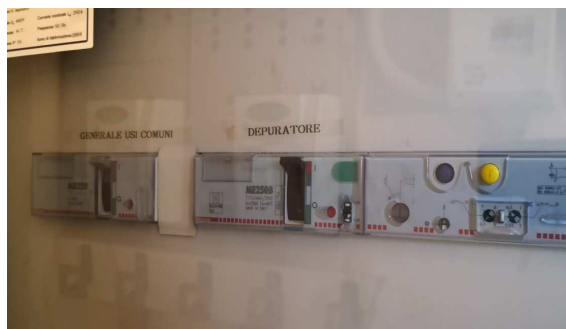
Interruttore generale depuratore su quadro elettrico scuola
