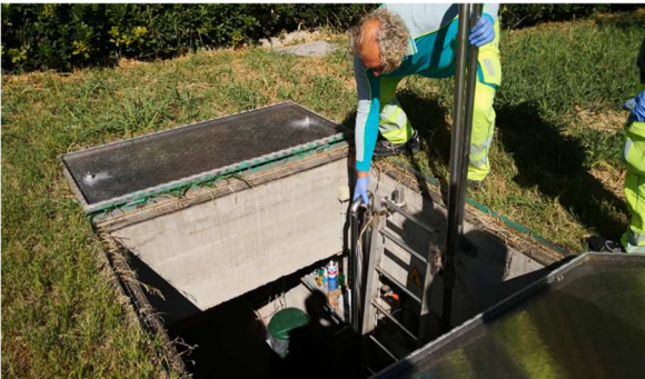
Ingresso locale tecnico
