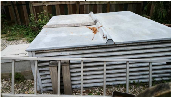
Accesso locale tecnico
