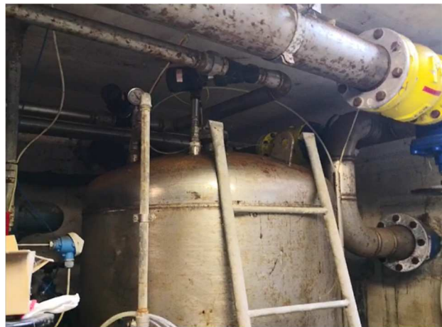
Serbatoio del vuoto
