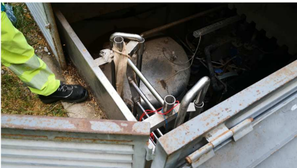
Accesso locale tecnico
