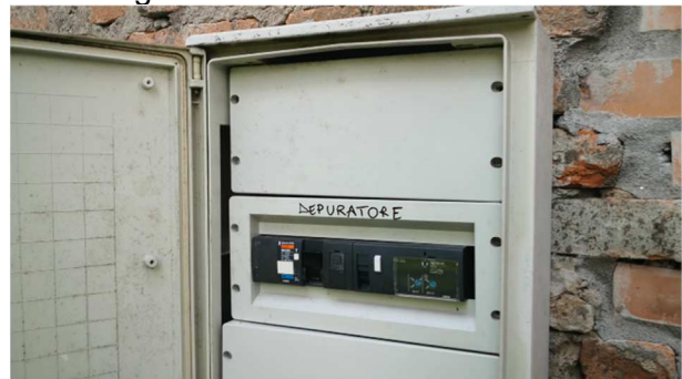
Quadro generale depuratore
