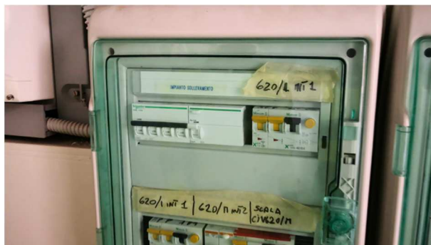
Quadro elettrico sollevamento
