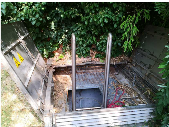
Ingresso locale tecnico
