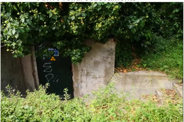
Ingresso locale tecnico
