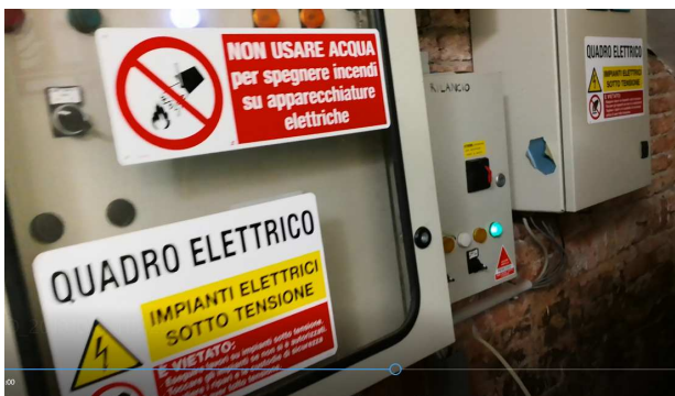
Quadri locale tecnico
