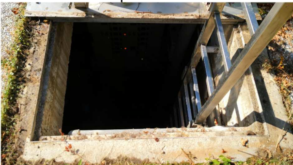
Accesso Locale tecnico
