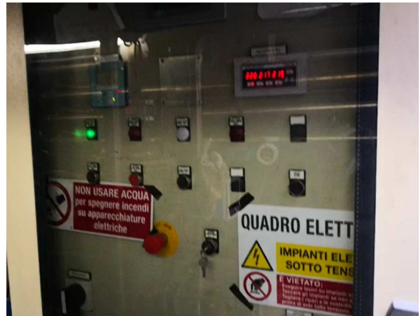
Locale tecnico: quadro comandi
