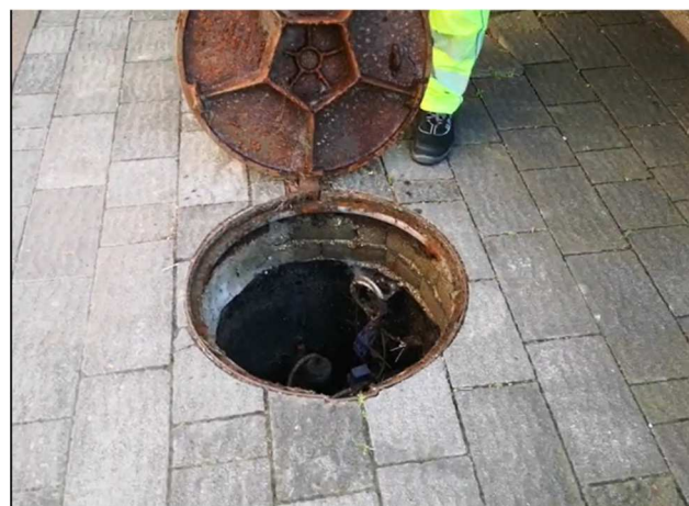
Pozzetto interfaccia linea depressione
