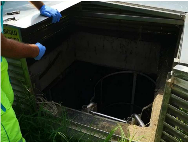
Accesso Locale tecnico MBR
