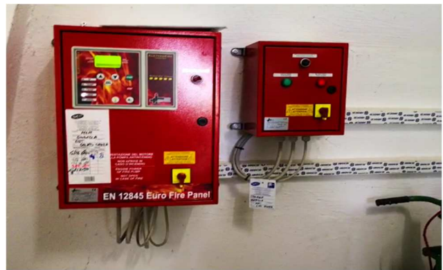
Centralina impianto antincendio scuola
