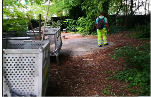
Area vasche depuratore
