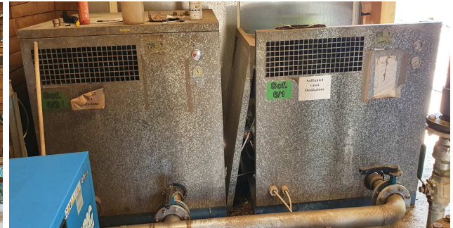
Soffianti nel locale tecnico
