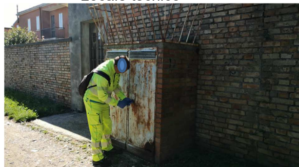
Quadro elettrico principale
