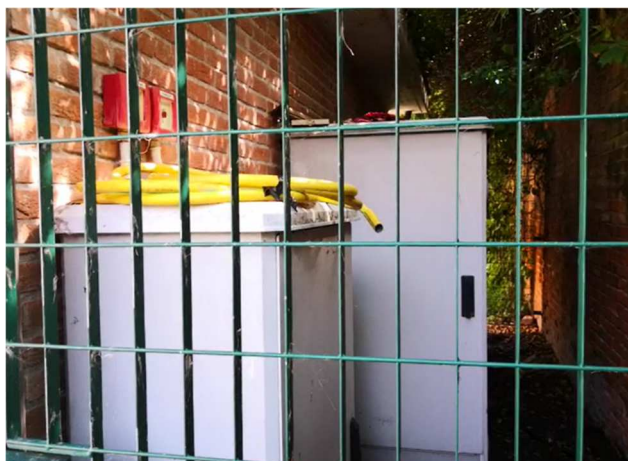
Quadro elettrico principale
