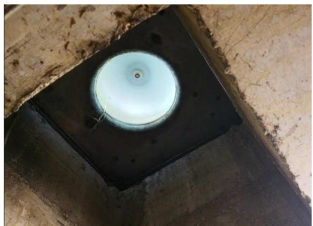
Estrattore d'aria locale tecnico
