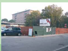
All'angolo tra via monte Cervino e via Monte Bianco, il cantiere per la costruzione dell'ecocompattatore.
