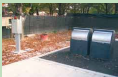
Le colonnine per l'inserimento dei rifiuti e, a destra, il quadro elettrico dei comandi.
